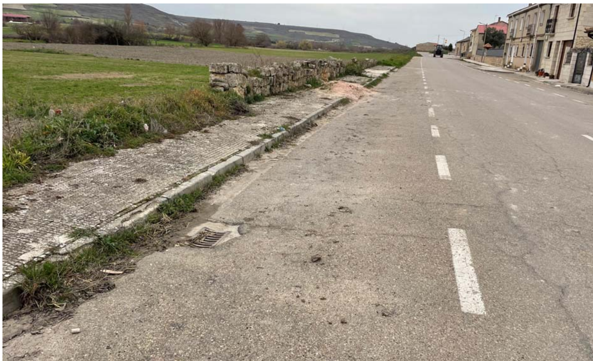
Fotografía IV. Estado actual de travesía Castrillo de Murcia.
