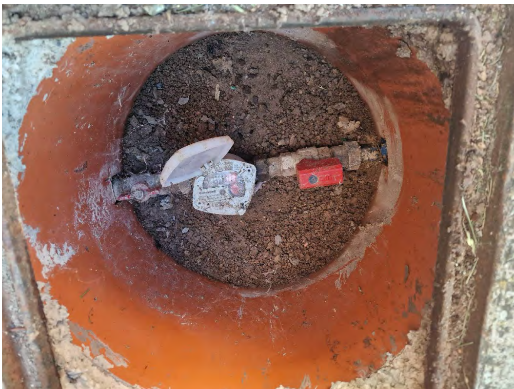
Contador domiciliario alojado en arqueta en vía pública
