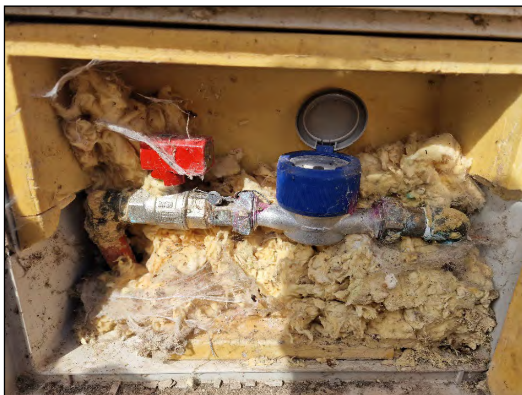
Acometida domiciliar en pared. Acometida particular.
