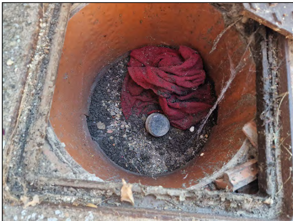
Acometida domiciliar en acera
