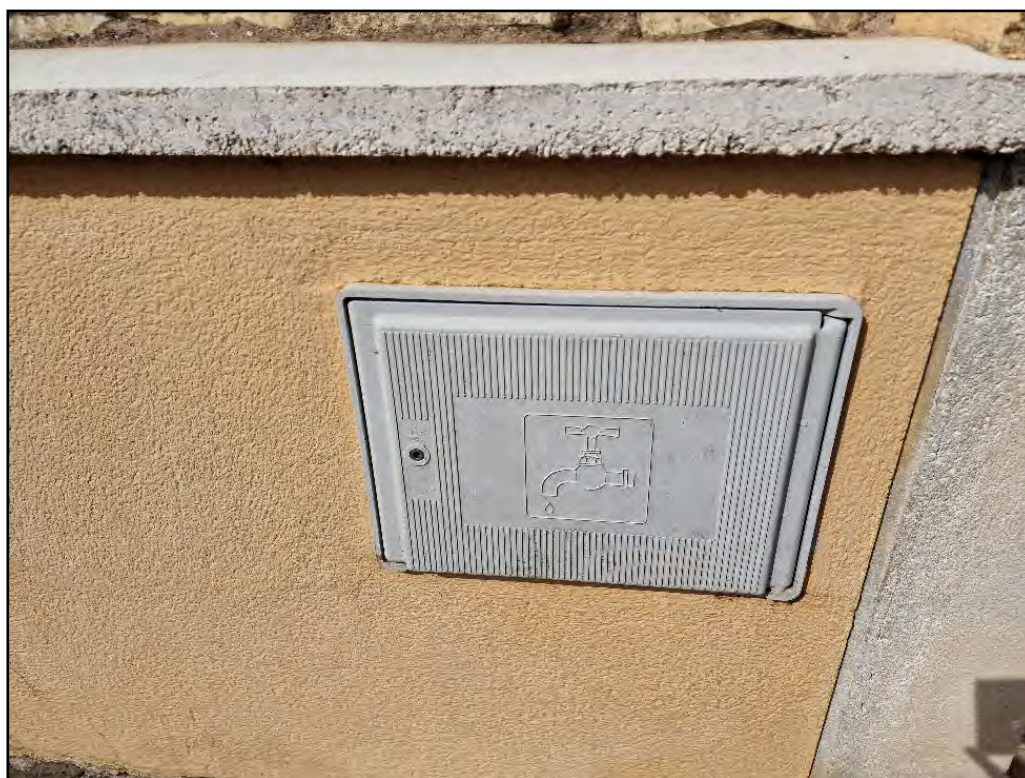
Acometida domiciliar en pared. Acometida particular.
