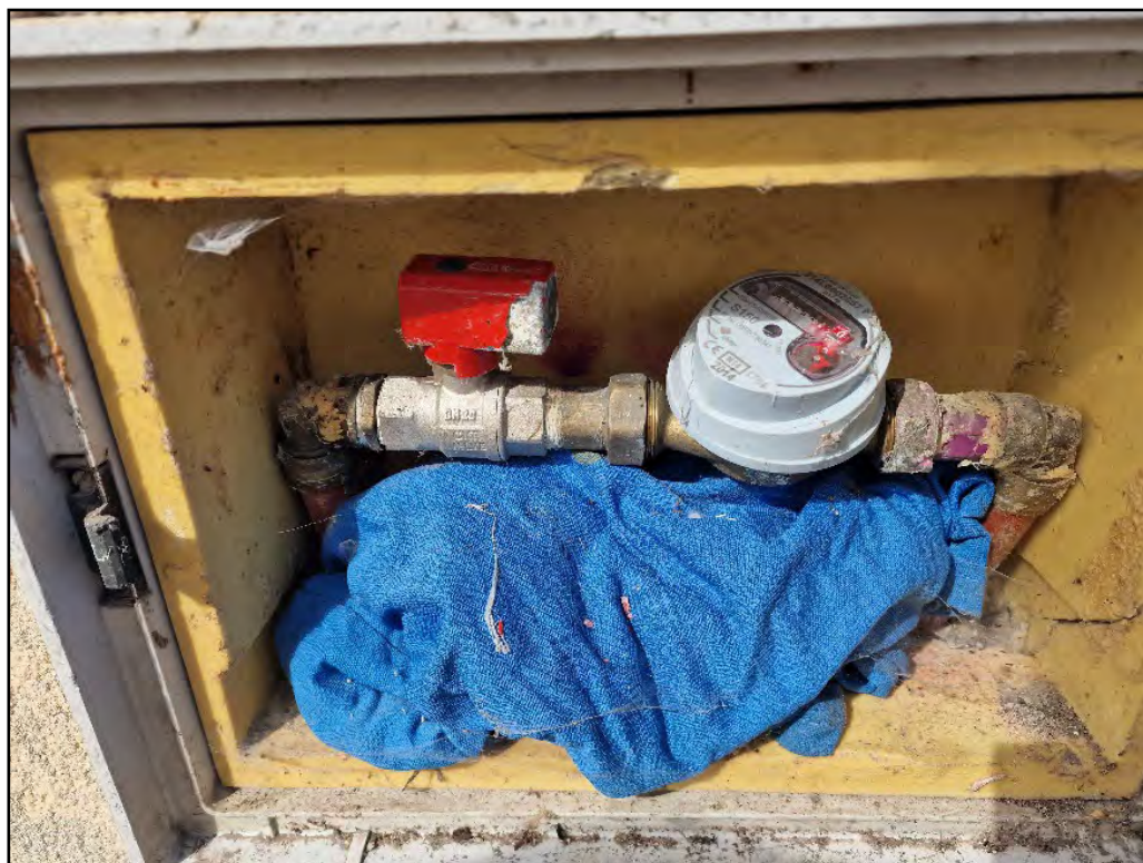
Acometida domiciliar en pared
