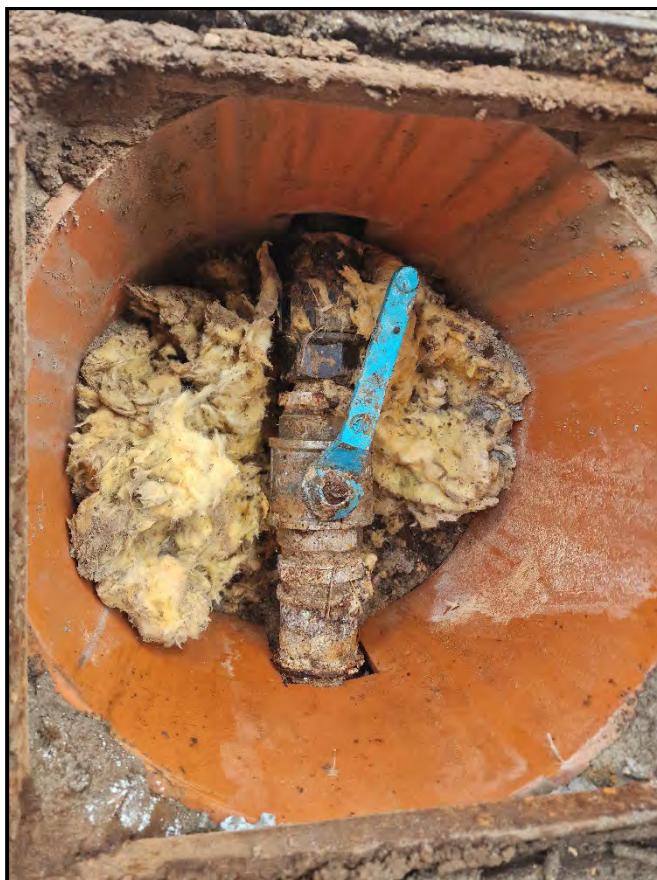
Arqueta domiciliar en bloque de viviendas, contador en el interior del edificio
