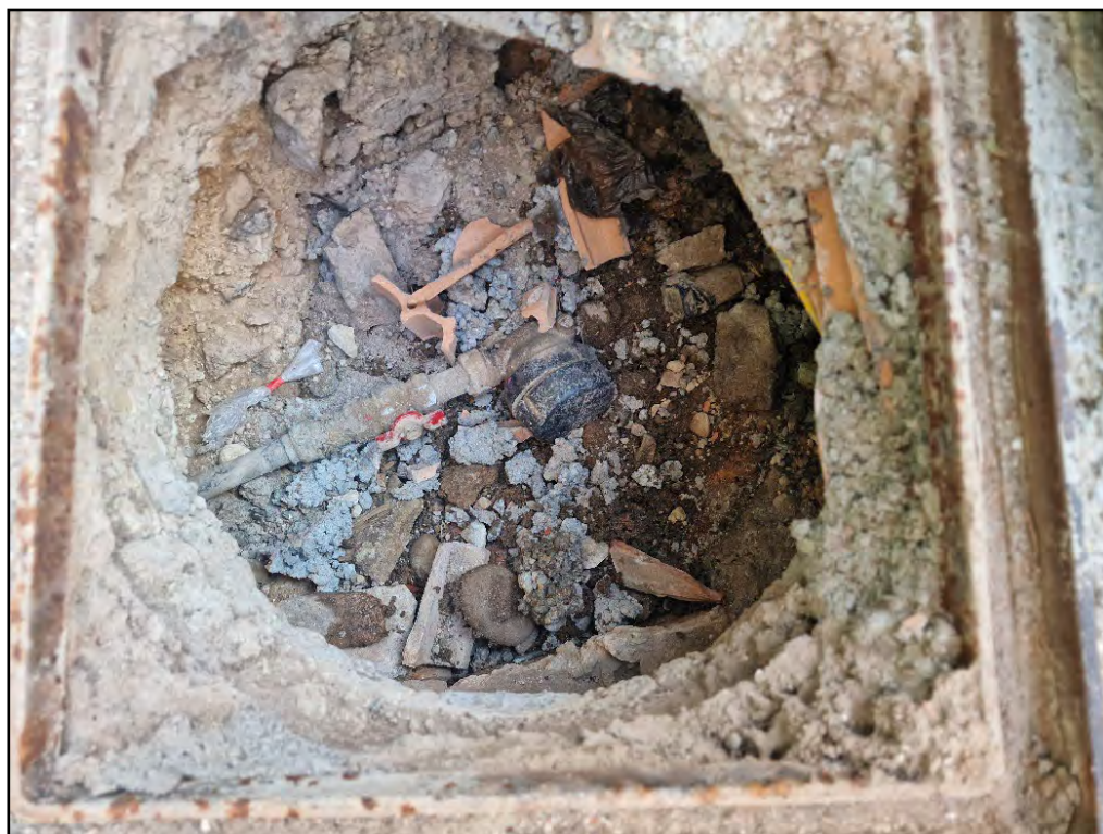
Acometida domiciliar en acera
