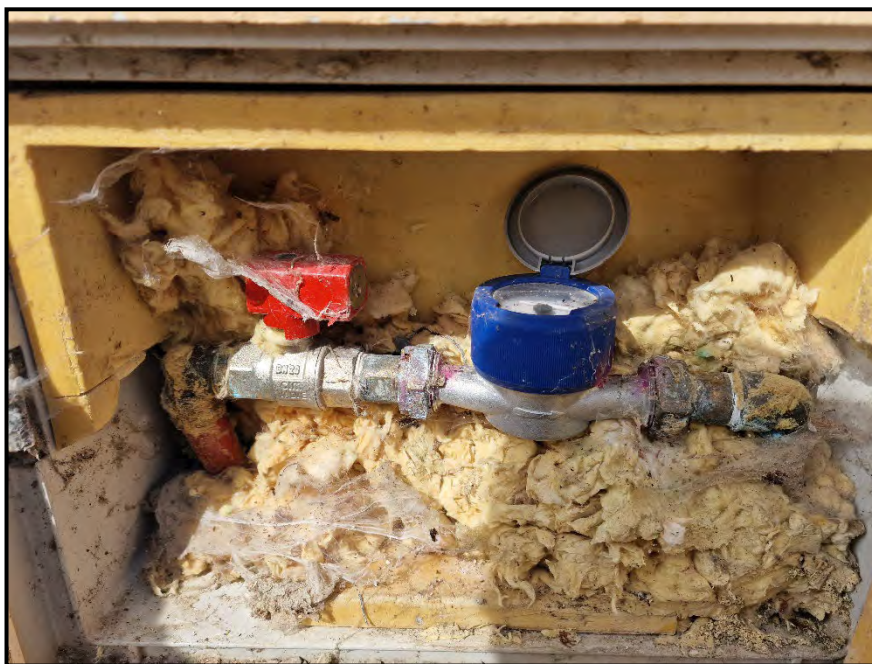
Contador domiciliario alojado en arqueta de pared
