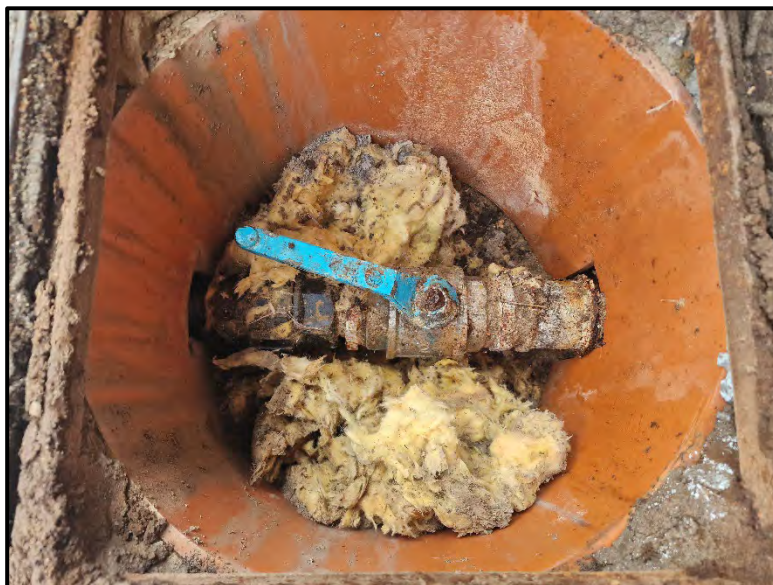
Acometida domiciliar en bloque de viviendas
