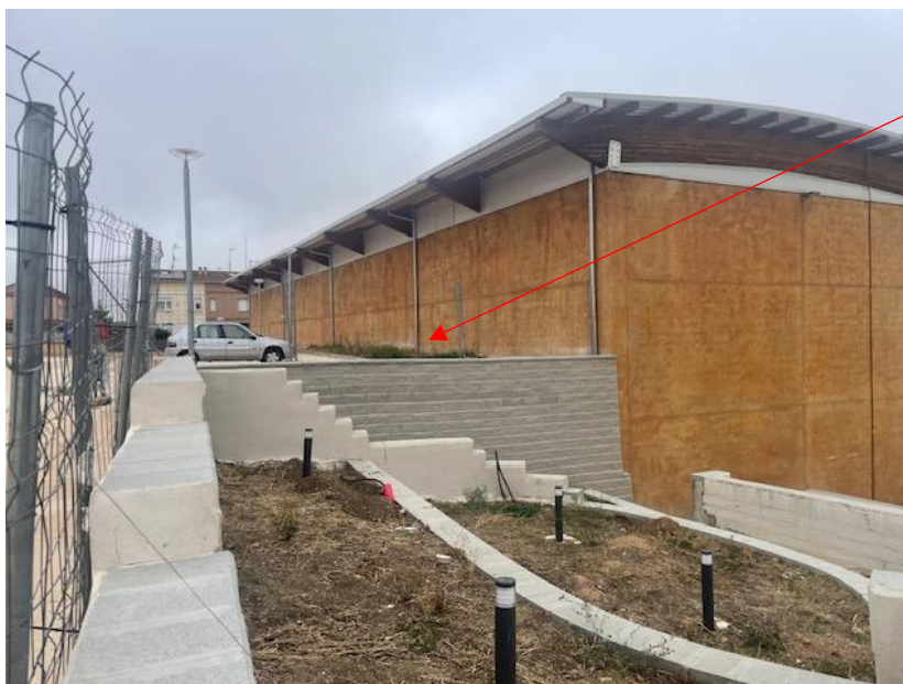
Zona a instalar barandillas
