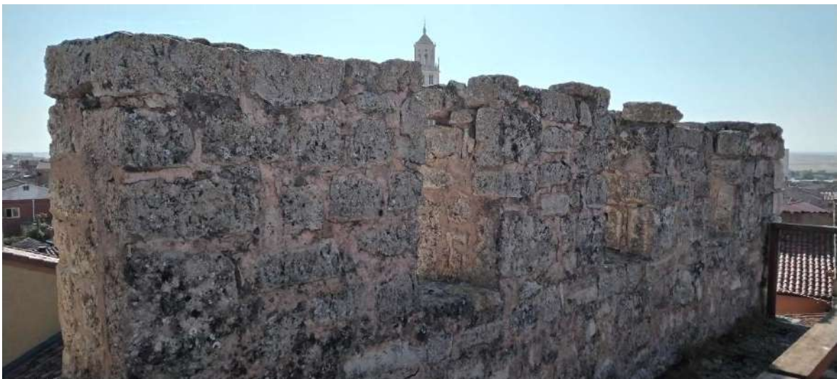
VISTA DEL MORTERO DE CEMENTO EN EL REJUNTADO DE LA FÁBRICA
