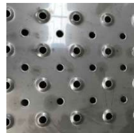
pavimento chapa perforada
