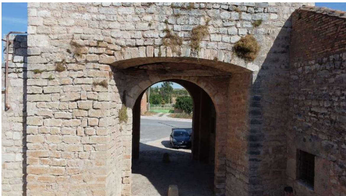
PRESENCIA DE VEGETACIÓN EN LA FACHADA SUDOESTE
