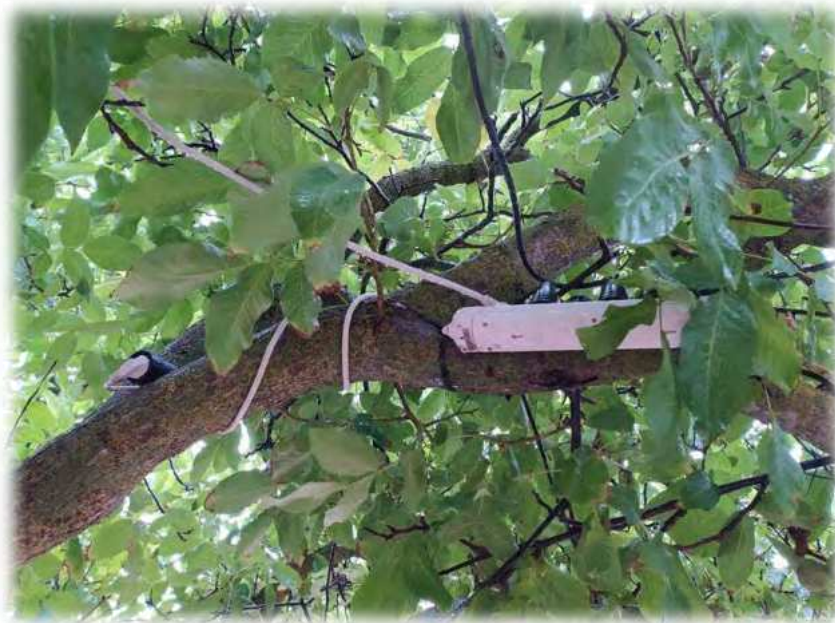
Foto. 25.2. Sistema eléctrico instalado en ramas principales
