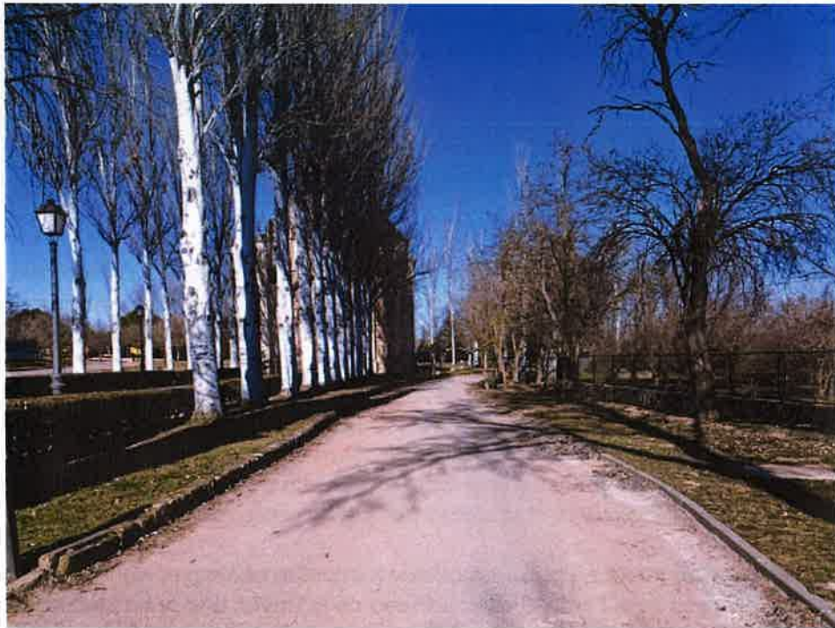
Imagen 3. Pavimento con baches y deteriorado en el Paseo.
