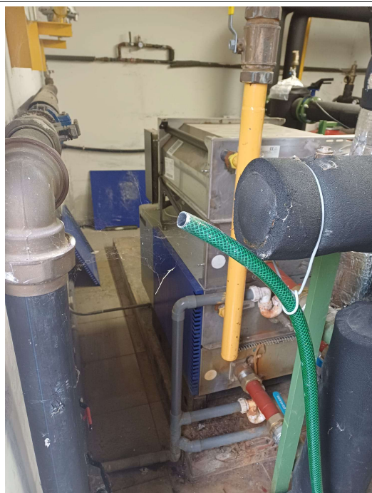
Vista lateral del conjunto de calderas.
