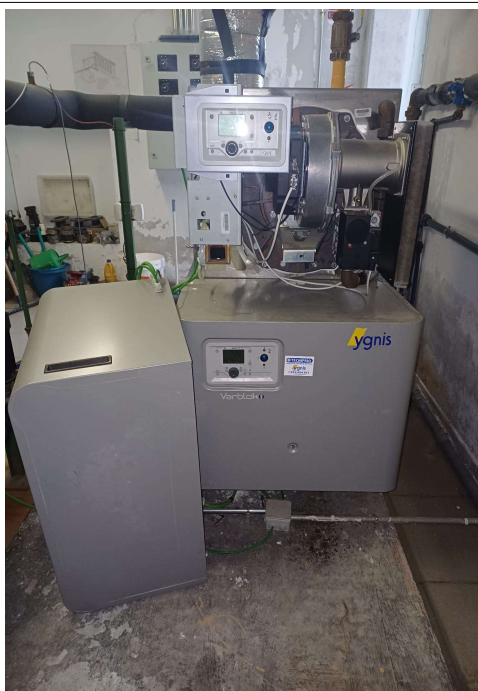
Vista frontal del conjunto de calderas. Superior dañada a sustituir
