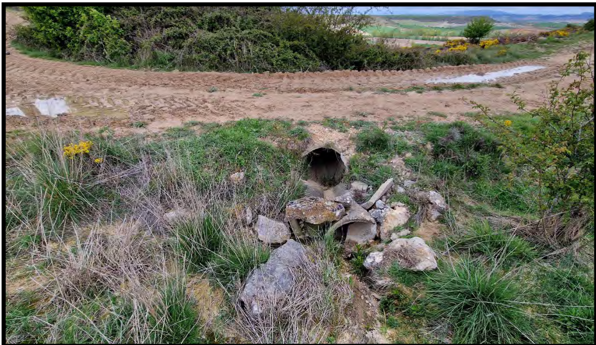
Caño existente en mal estado de conservación
