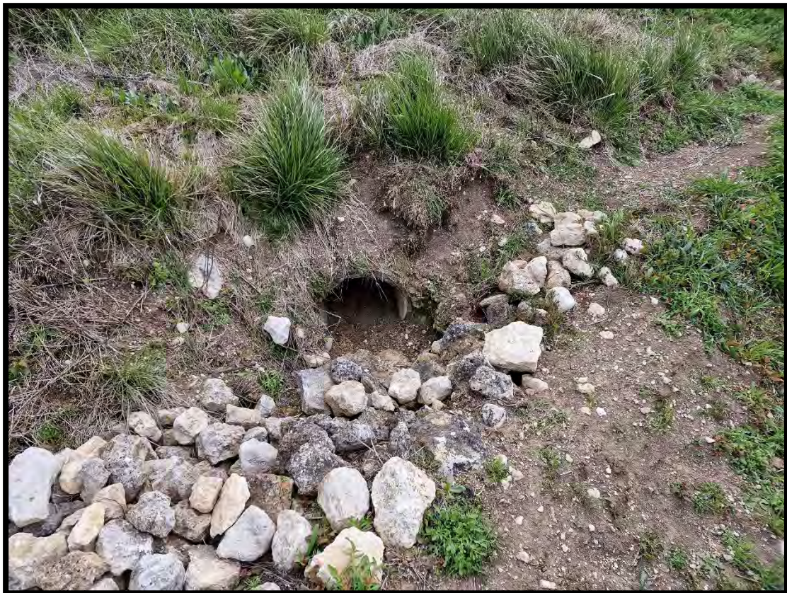
Obra de fábrica con arrastre de material colindante
